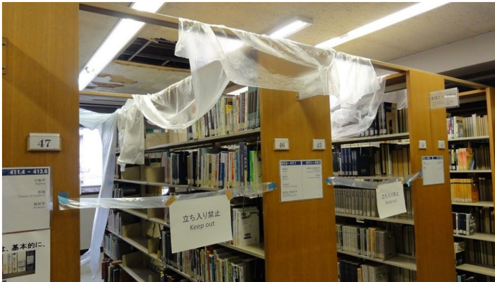
2017年に発生した水漏れによって崩落した天井と応急処置が施された書架 図書館所蔵資料
